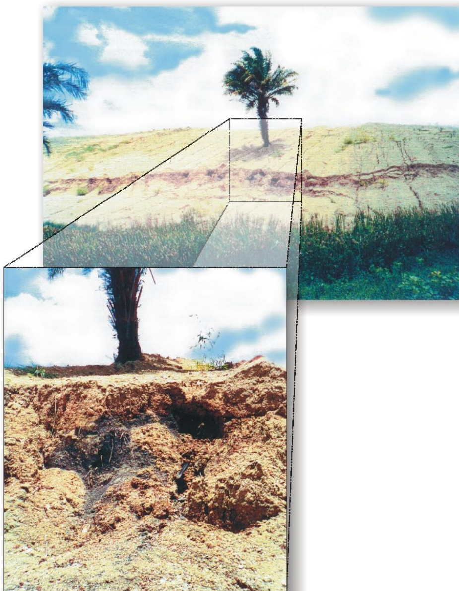
Fotos 8.5 e 8.6 – O rompimento do talude nas proximidades da zona alagadiça alcançou grande área e (em detalhe) expôs a escória que deveria encontrar recoberta pelo solo.
