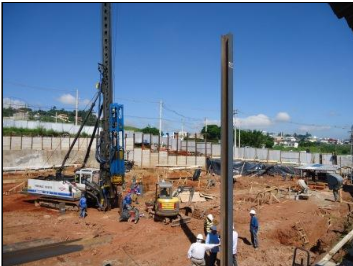
Fig 16 – Empreendimento imobiliário ocupando gleba com concentração de vazios cársticos. As condições geológicas levaram à opção por estacas metálicas cravadas e tratamento dos vazios cársticos com injeção de calda de cimento. Foto ARSantos
