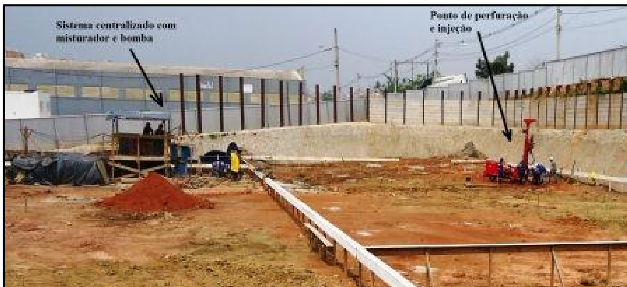
Fig 21 – Sistema centralizado com misturador e bomba atendendo vários pontos de injeção. Foto ARSantos.
