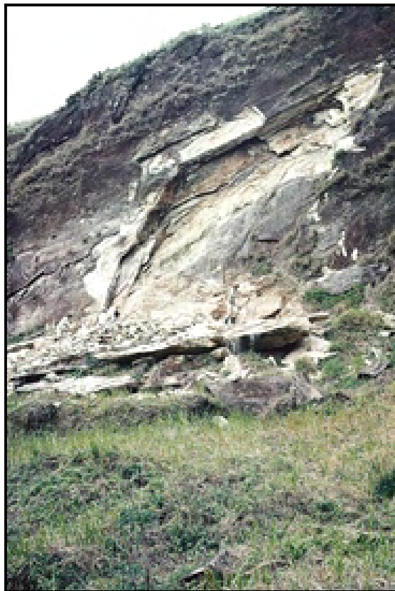
Ruptura em rocha condicionada por fraturamento associado à Falha de Cubatão. (Foto IPT)
