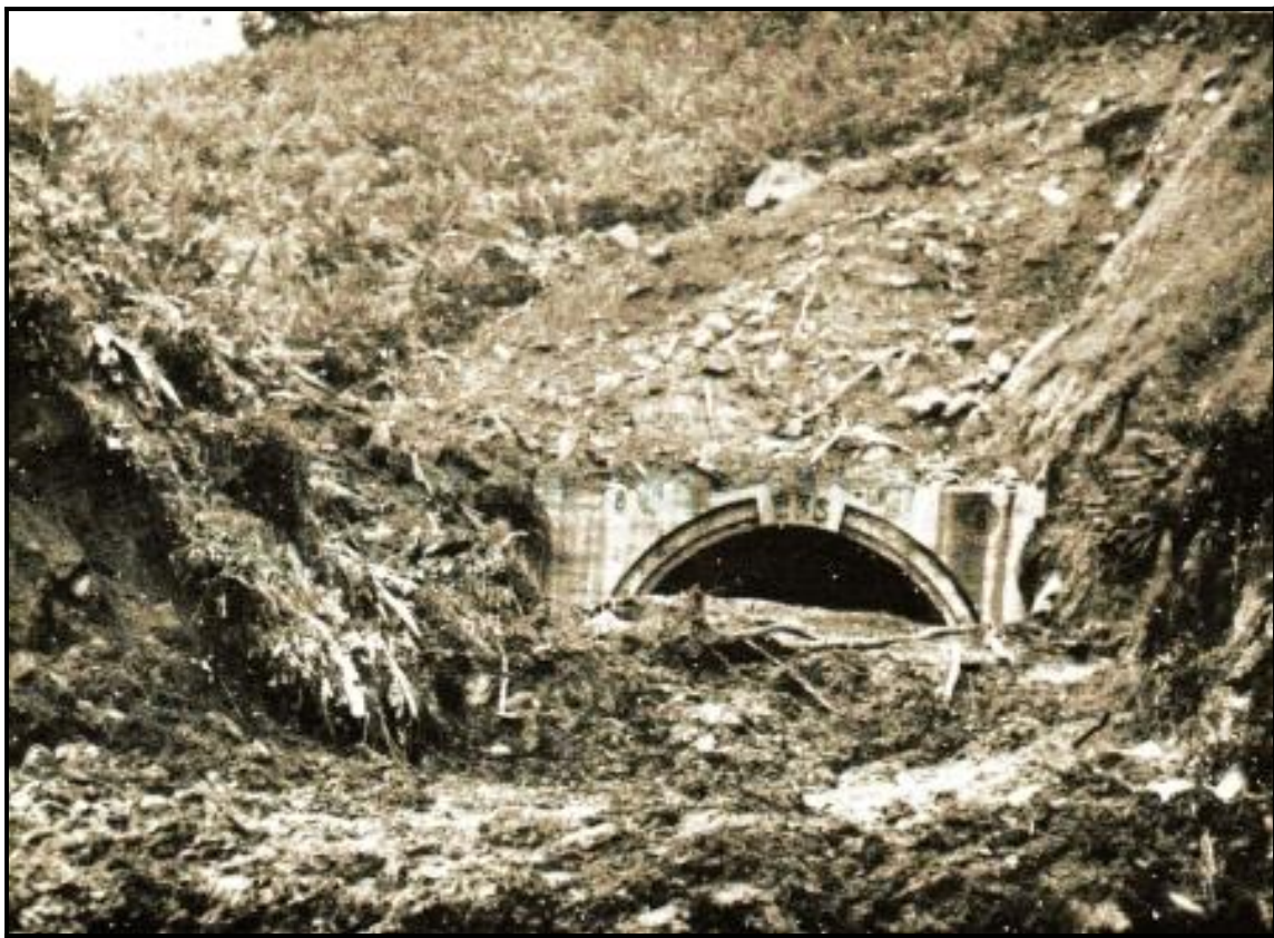
Deslizamento em solo superficial com blocos ocorrido em janeiro de 1976 acarretando a completa obstrução do emboque sul do Túnel 8. (Foto Arquivo IPT)
