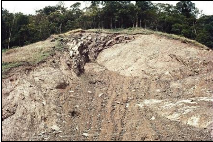
Colapso em saprolito condicionado por combinações desfavoráveis de planos de fratura e cisalhamento do maciço rochoso com o plano e inclinação do talude. Por apresentar grande influência da Falha de Cubatão, a vertente direita do Vale do Rio Cubatão mostrou-se adicionalmente instável ante os cortes para implantação da ferrovia. (Foto IPT)
