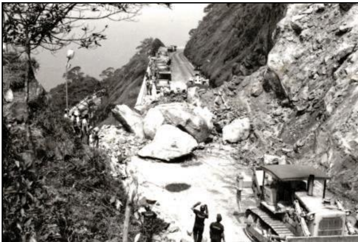
Desmoronamento em rocha com total interrupção do tráfego por muitos dias na pista ascendente da Via Anchieta no verão de 1970. Evento induzido pelo corte na encosta, o que promoveu uma combinação desfavorável entre planos de fraturas da rocha com o plano do talude. (foto Arquivo DER – SP)
