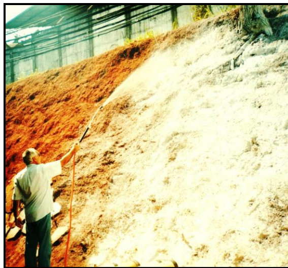
Talude sendo protegido da erosão com pulverização de calda de cal – Técnica Cal-Jet.
