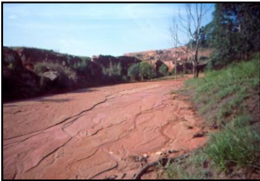
Córrego totalmente assoreado. Capacidade de vazão completamente comprometida
