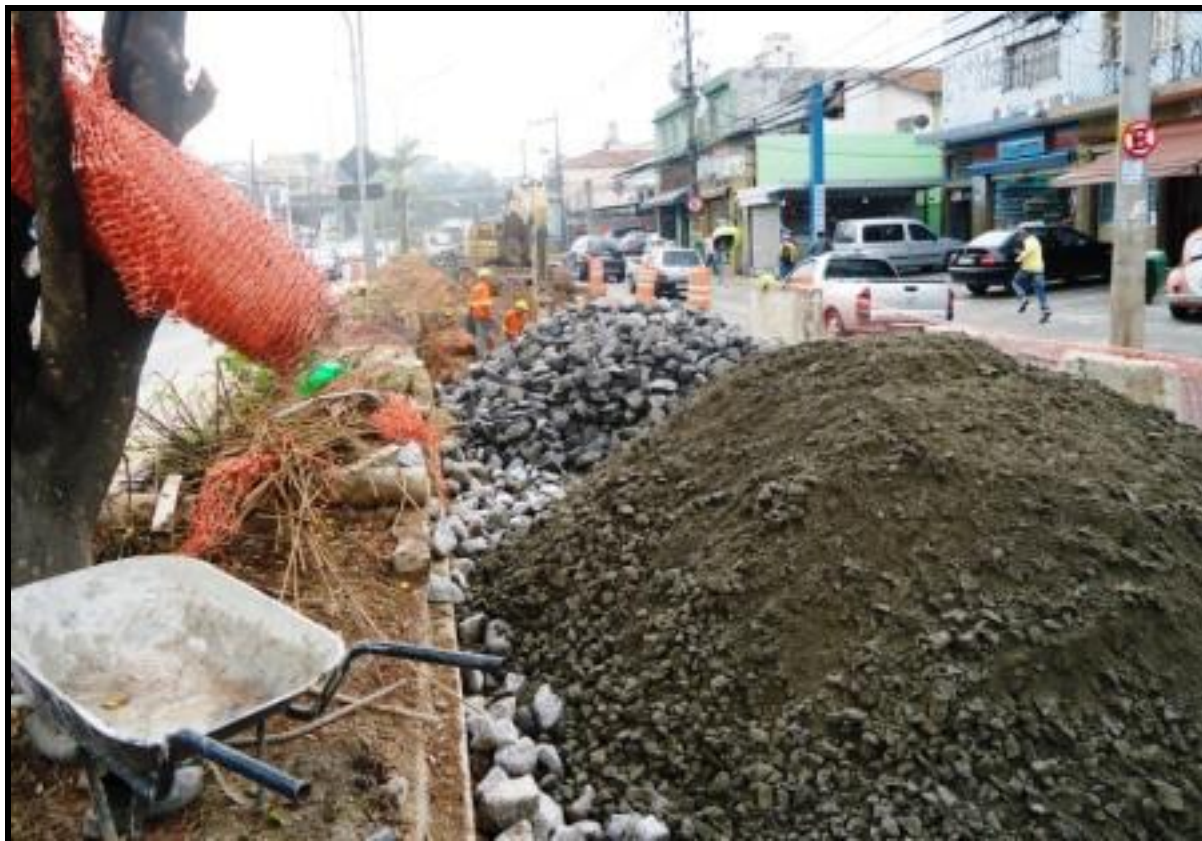
Execução de berço de galeria de drenagem com rachão selecionado e brita graduada, serviço que poderia ser perfeitamente realizado com a utilização de entulho de construção civil em estado bruto ou semi-bruto, com grande economia para a administração pública e enorme benefício para a sociedade. São Paulo, Capital. Foto ARSantos
