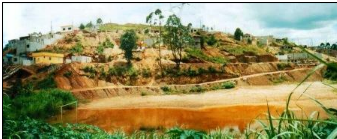
Processos erosivos generalizados em terraplenagens pontuais em loteamento clandestino. Notar o campo de futebol abaixo já totalmente assoreado
