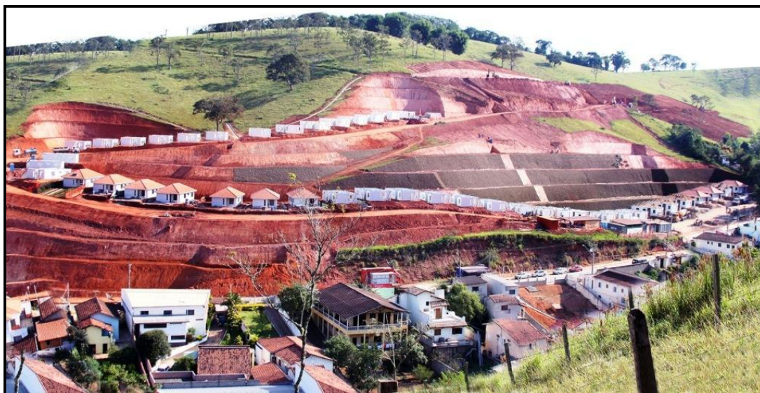
Absurdas e desnecessárias mutilações no terreno natural expõem os solos à erosão
