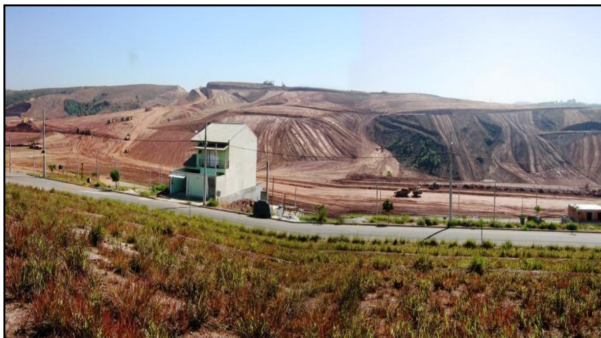
Os mesmo processos erosivos verificam-se em terraplenagens extensas para empreendimentos de alto padrão. A questão é cultural, não social.
